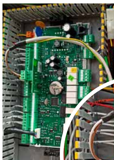
⑦b Particolare connessione \mu PC BMS
