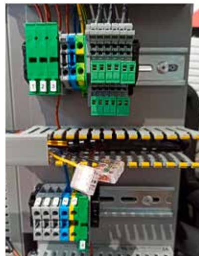
③ Particolare canalina
