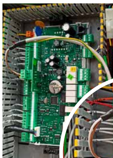
⑦b Particolare connessione \mu PC BMS
